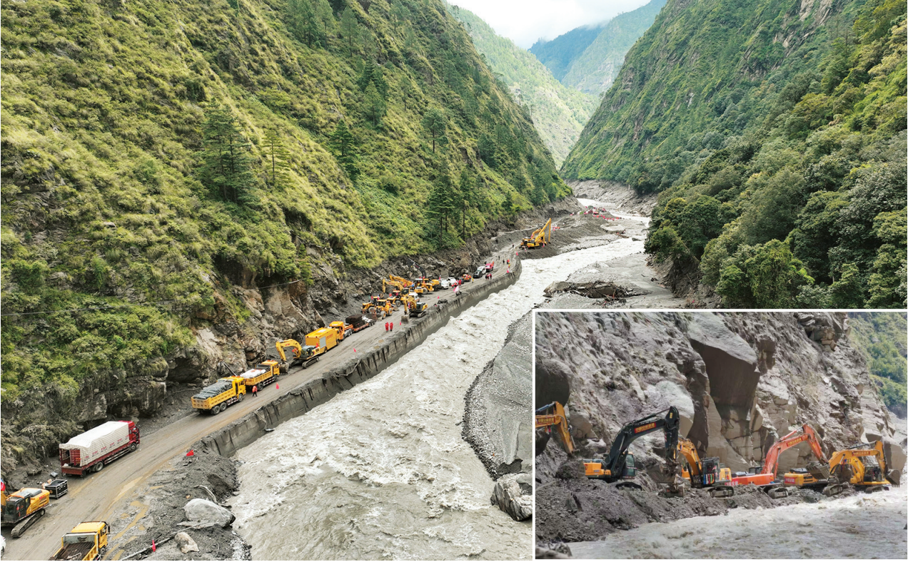
上图均为8月29日，救援力量持续对G216国道损毁路段全力开展抢通作业。（新华社发）
