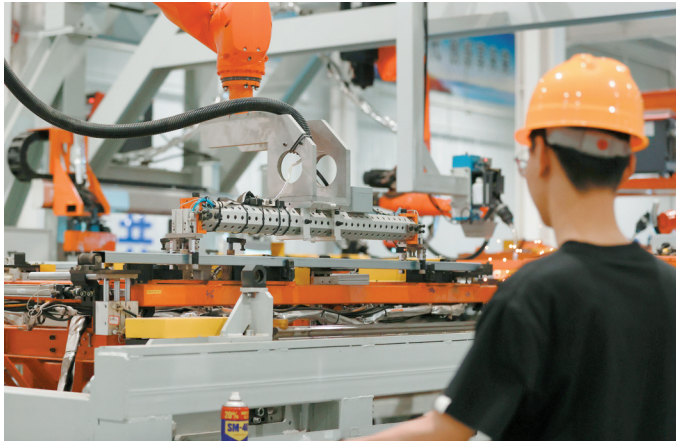
图为在安平县丝网集团共享智造中试工厂，工作人员在监测机械臂进行运输(7月6日摄)。(新华社发)
