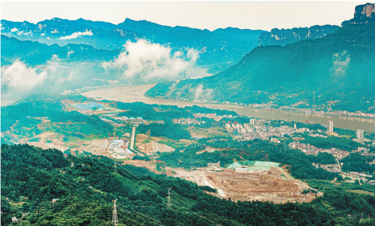
图为6月8日拍摄的三峡水运新通道工程三峡枢纽新通道施工现场。
