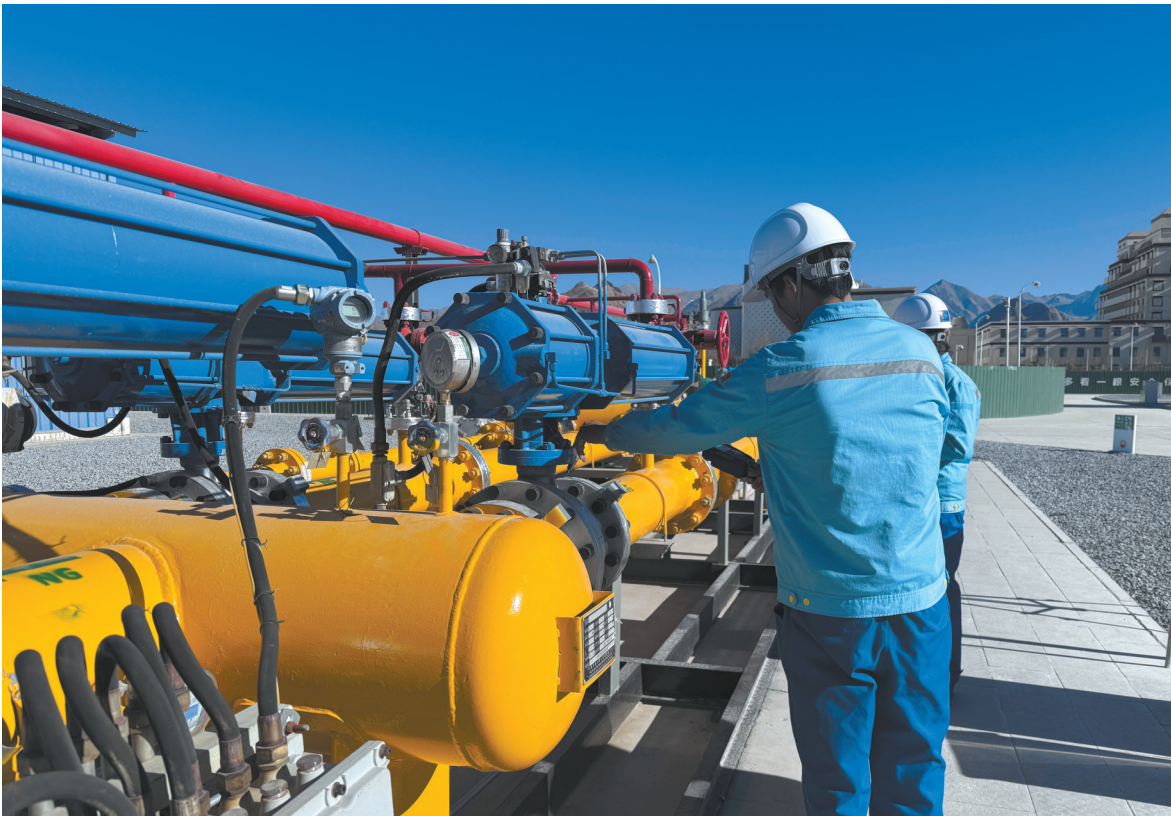
图为拉萨天然气站工作人员巡检站内管线。 拉萨融媒记者 李从芳摄
