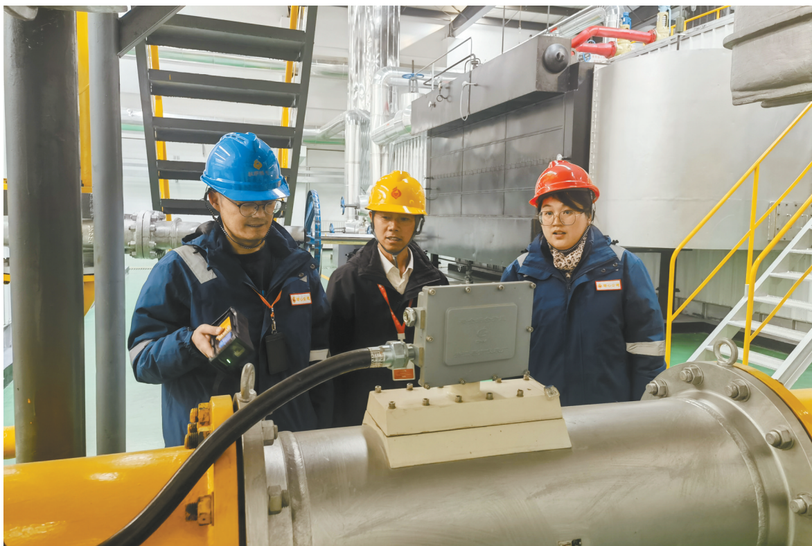
图为拉萨市暖心公司相关工作人员在教育城锅炉房进行点炉前的燃气安全检查。
